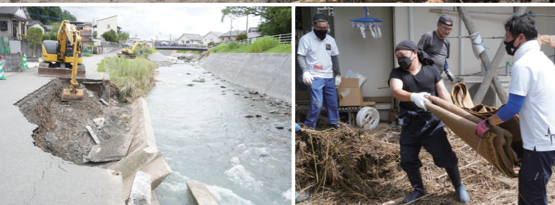
10日に線状降水帯が発生し、記録的な大雨が降り続けました。市内全域にレベル5「緊急安全確保」を発令。田主丸町竹野で土石流が発生するなど大きな被害が出ました
