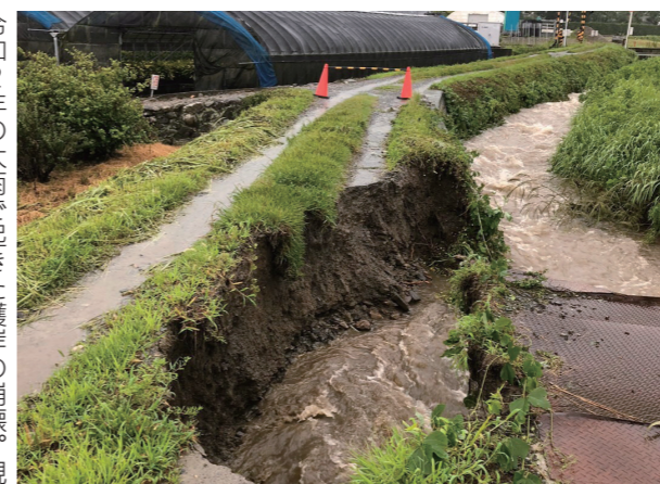
令和2年の大雨で起きた護岸の崩壊。現場写真をLINEで見ることが出来ます
