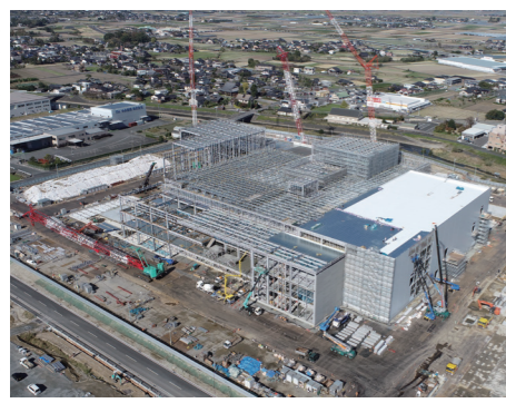
土地面積約9.7万㎡、延床面積約7万㎡の福岡久留米工場(資生堂提供)
