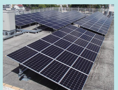
環境部庁舎の太陽光発電設備
