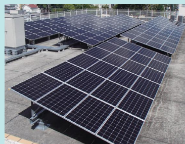
環境部庁舎の太陽光発電設備
