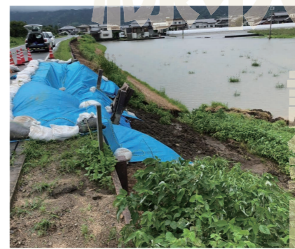
コスモス街道ののり面が崩落
