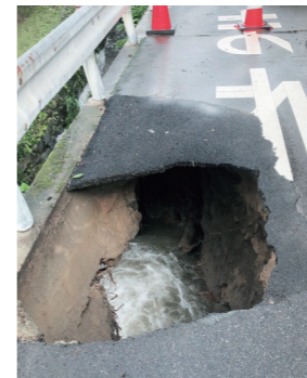
山本町では道路が陥没
