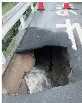
山本町では道路が陥没
