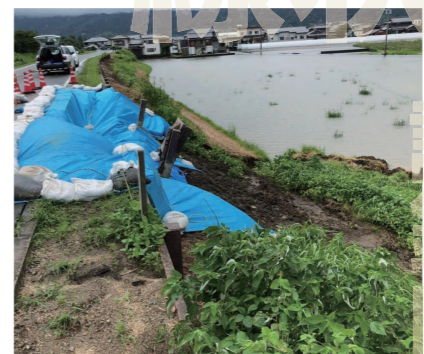
コスモス街道ののり面が崩落
