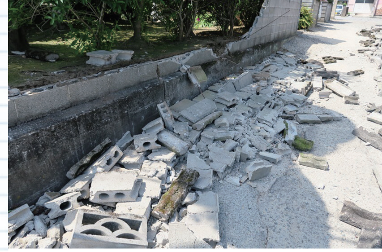
熊本地震で倒れたブロック塀 (防災システム研究所提供)
