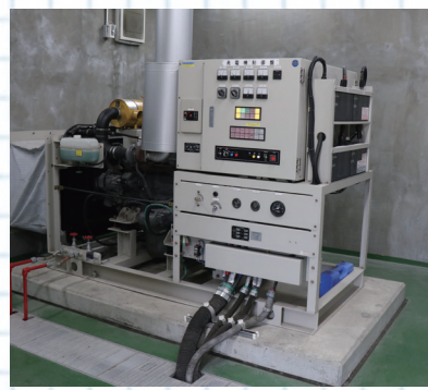
備蓄倉庫横にある自家発電機
